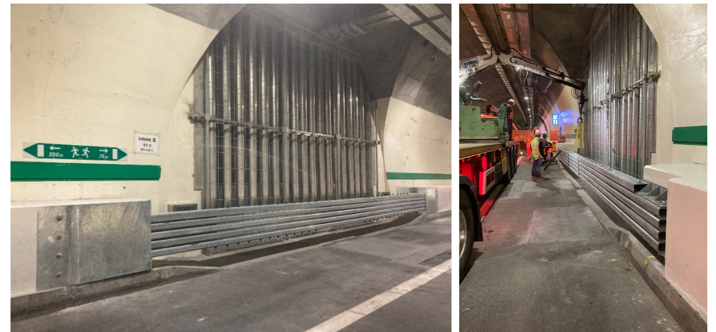
Installation des dispositifs de retenue au droit des entonnements de l'usine E de désenfumage
